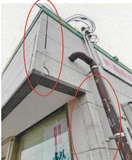
外壁シーリングのヒビ割れの状況
