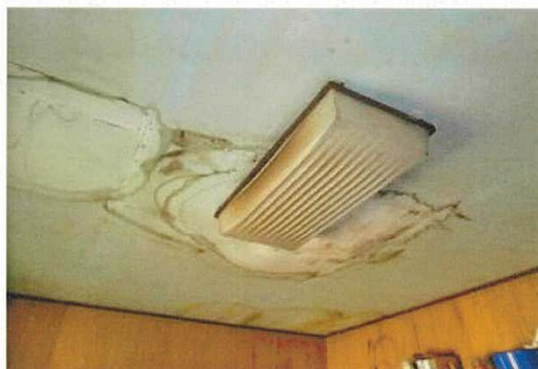
雨漏り痕の状況
