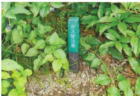
LPガス集中配管の状況
