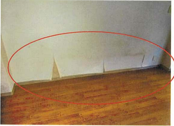
壁紙が剥離している状況
