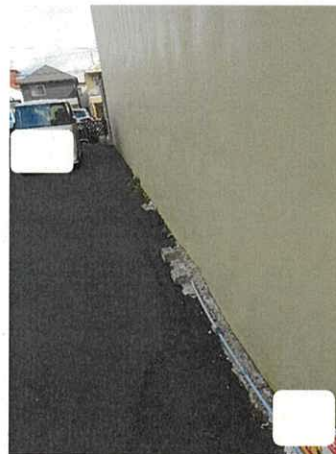
④ 物件2 外壁の浮き
