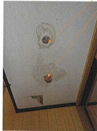
④ 物件2内部 1階 玄関天井損傷
