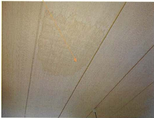
⑮ 雨漏り跡
