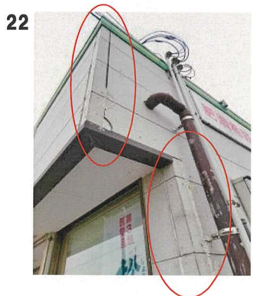
外壁シーリングのヒビ割れの状況
