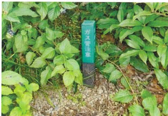
L Pガス集中配管の状況
