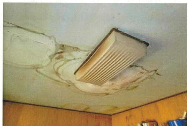
雨漏り痕の状況
