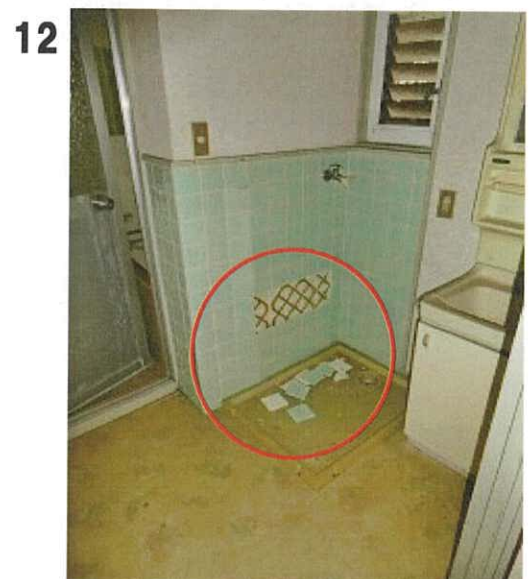
壁面タイルの剥落状況
