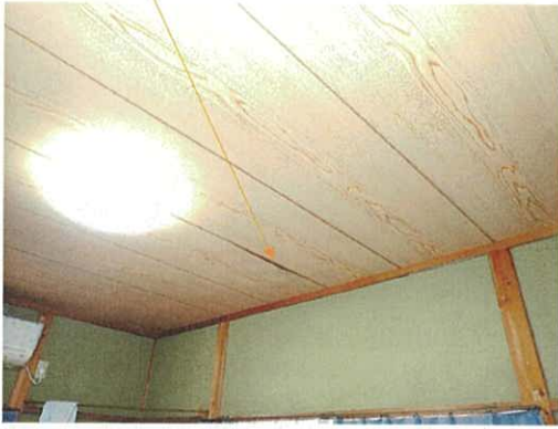
③⑦ 雨漏り跡
