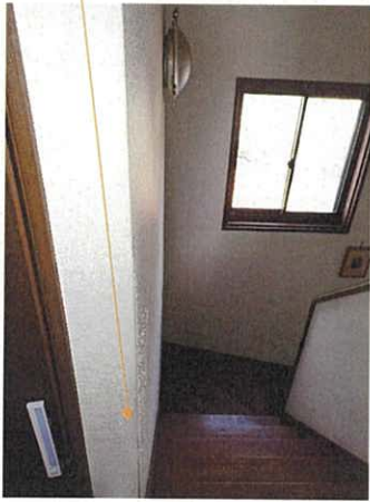
⑮ 内壁損傷
