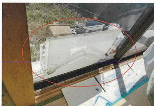
窓ガラスのヒビ割れの状況
