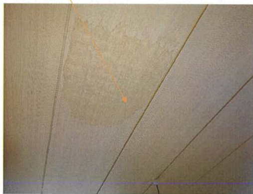
⑮ 雨漏り跡
