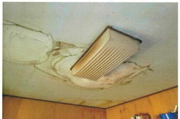
雨漏り痕の状況
