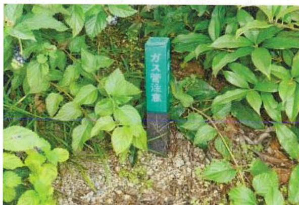
L P ガス集中配管の状況
