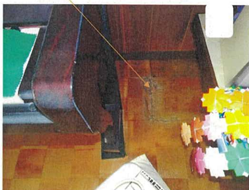
⑤ 床板損傷
