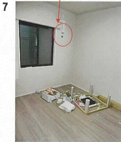
配管キャップがない状況
