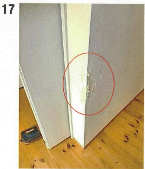
内壁の損傷状況
