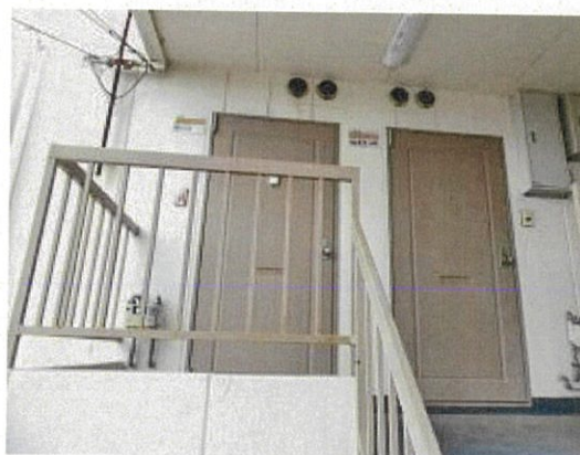
3階玄関ドア付近の状況
