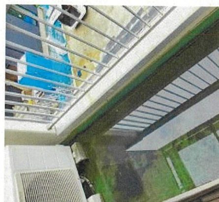
ベランダに水が溜まっている状況
