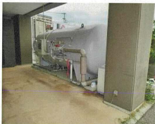
加圧送水装置の状況
