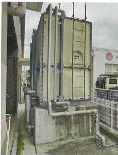
受水槽の状況
