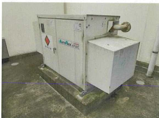
自家発電機の状況
