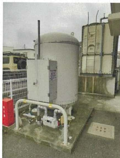
LPガス容器置場の状況
