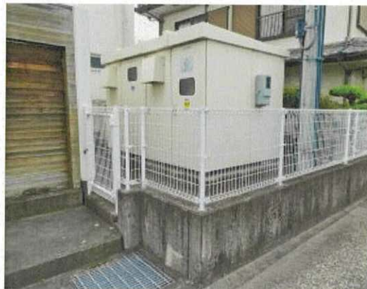
キュービクルの状況
