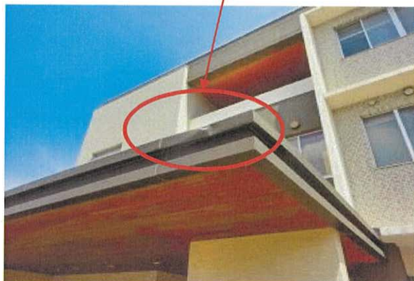
アンテナ落下による損傷箇所
