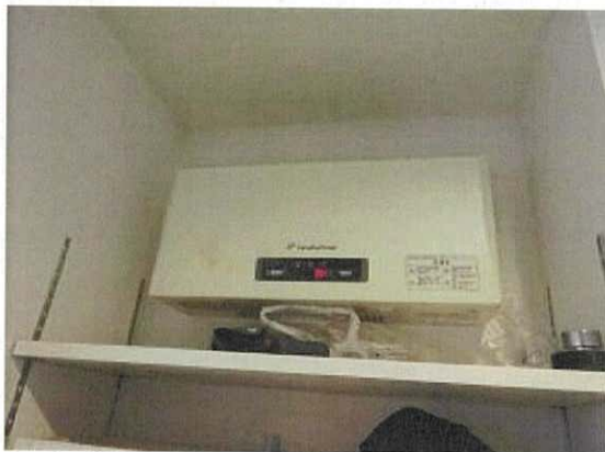
パワーコンディショナの設置状況
