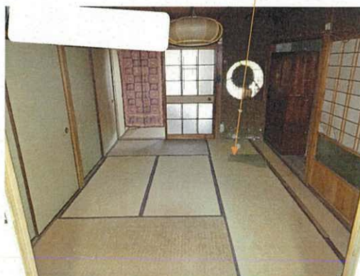
物件 4 建物 1 階 白蟻腐食跡
