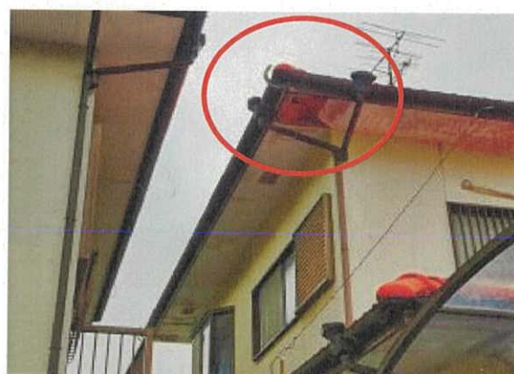
軒天の損傷状況
