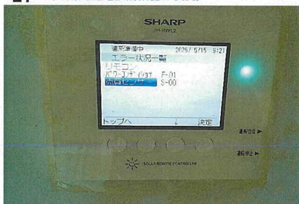
27 (太陽光発電設備機器の状況)
