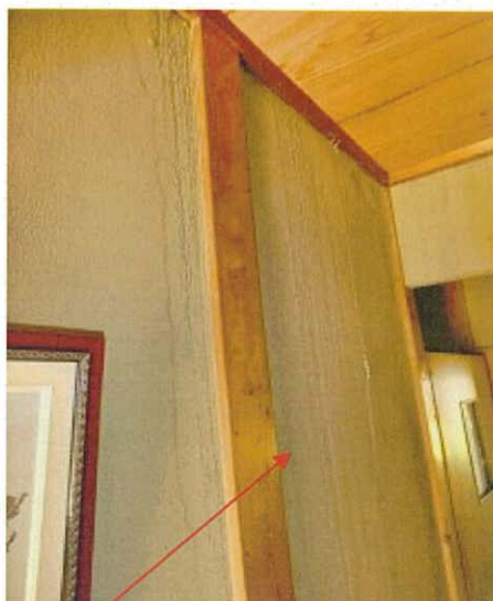
漏水痕の状況
