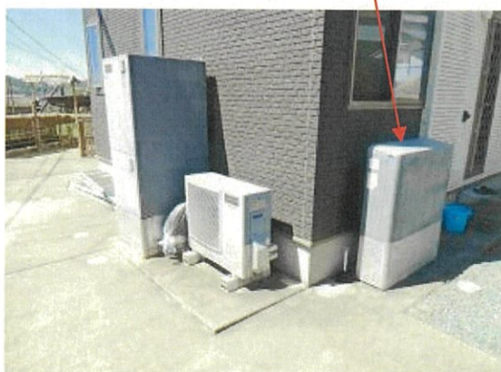
小型蓄電システム
