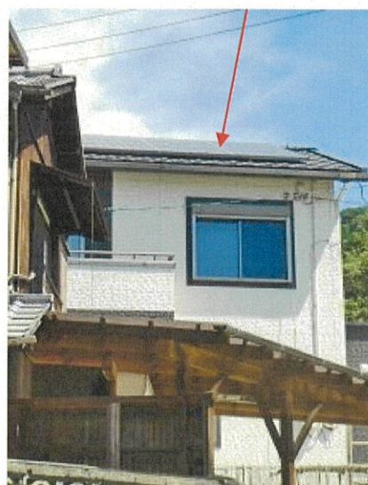
据置型の太陽光パネル
