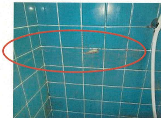
ヒビ割れ箇所の状況
