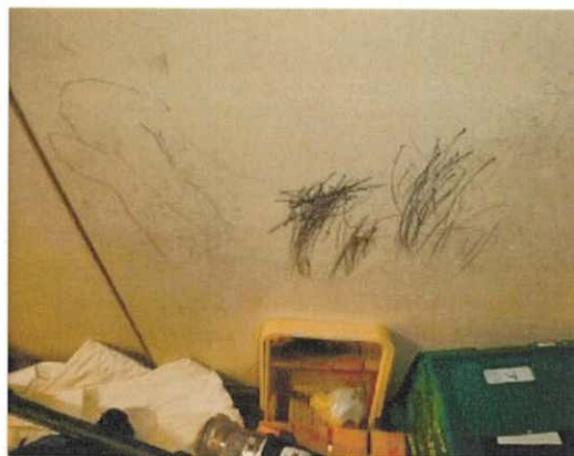
建具の汚損の状況
